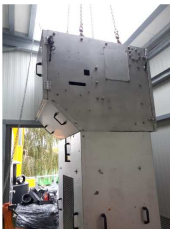
Nouveaux dégrilleurs au poste Sud
