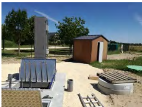
poste de relevage et prétraitements en entrée de station d'épuration
