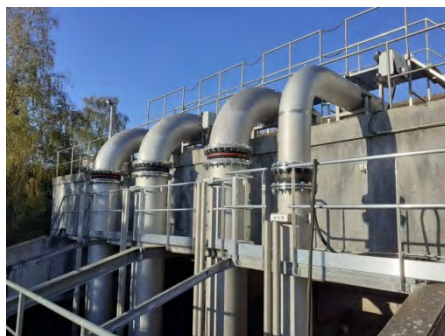
Conduite de refoulement
