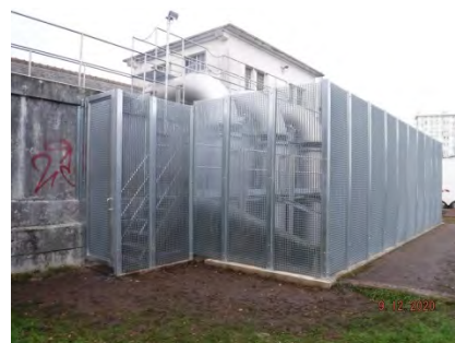
Fermeture garde de corps fosse
